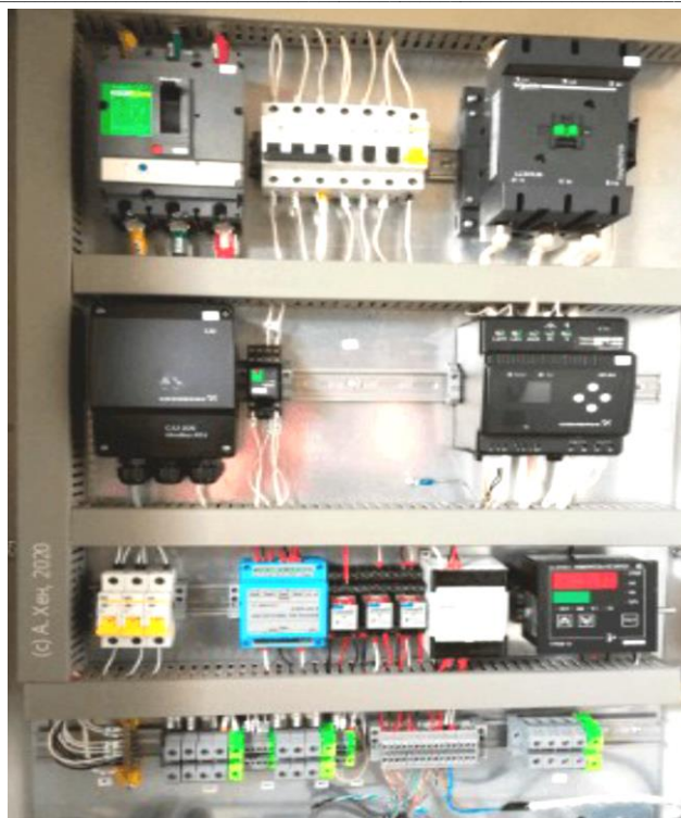
Рисунок 2. Шкаф управления (контроллеры, частотные и измерительные преобразователи) в водозаборном помещении
